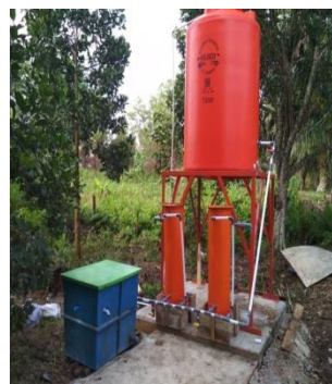
Gambar 2: Instalasi air dengan teknologi MMF
