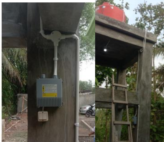
Gambar 3. Instalasi kontrol air dan stop kontak luar
