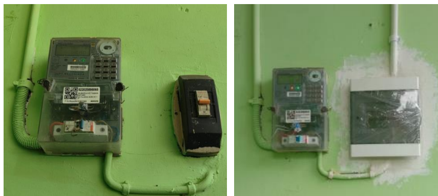
Gambar 2. Instalasi fuse box satu grup dan instalasi fuse box 4 grup
