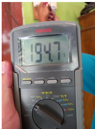
Gambar 1. Pengukuran awal tegangan ujung penerangan jalan
