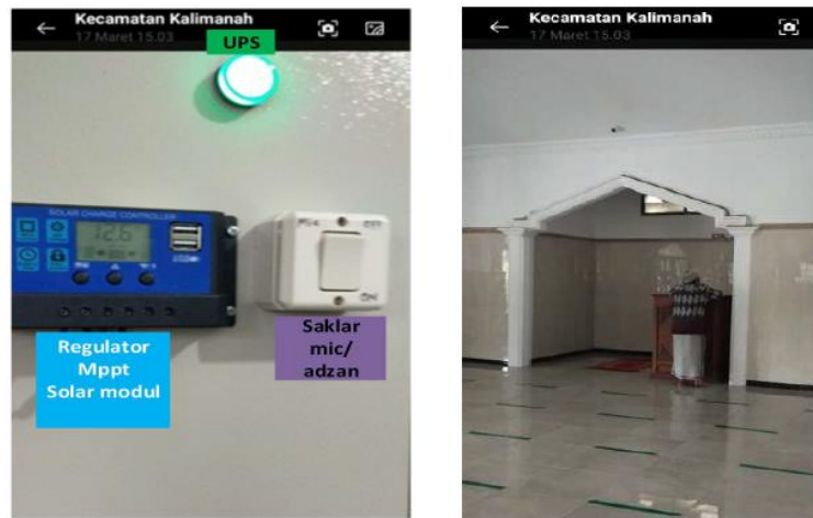
Gambar 4. Pengujian Sistem Cadangan Energi untuk Adzan Sholat Ashar
